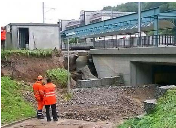
Das Bord der Unterführung bei der Haltestelle Reppischhof rutschte ab. Die Trafostation darüber war am frühen Morgen noch ohne Strom.
